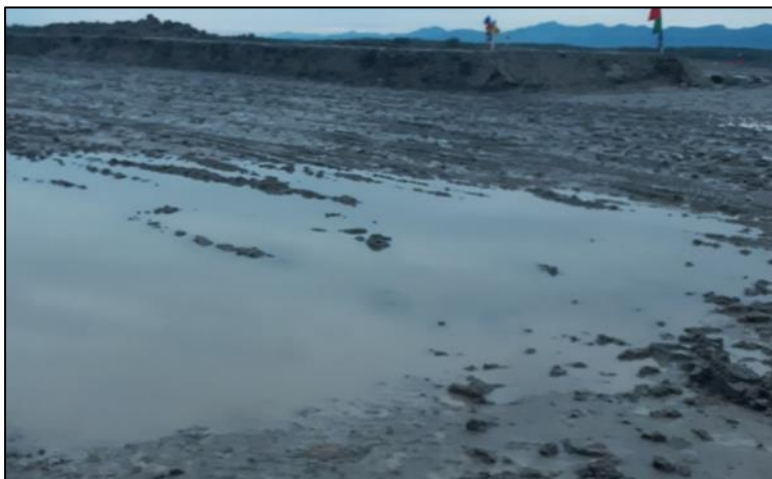
Gambar 3. Permasalahan cross fall pada segmen jalan 10-11 Jalan Highwall PIT KGS berupa air yang menggenang pasca hujan turun.
