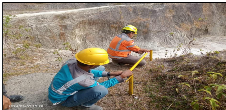
Gambar 9. Pemantauan lereng dengan menggunakan alat crackmeter
