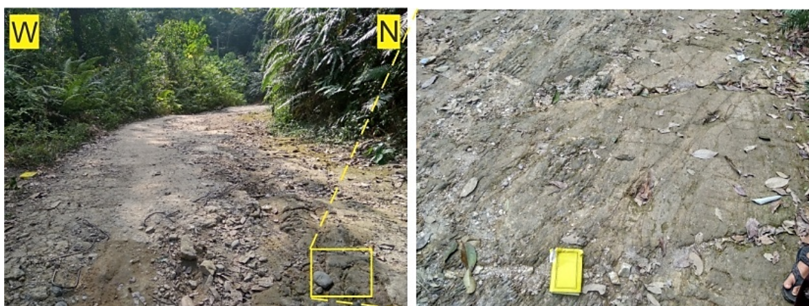
Gambar 9. Kondisi jalan di Desa Pekan Gedang, terdapat struktur kekar, litologi metapasir.
